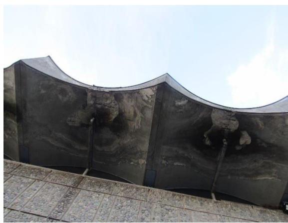
Techumbre: descascaramientos y caída de escombros
