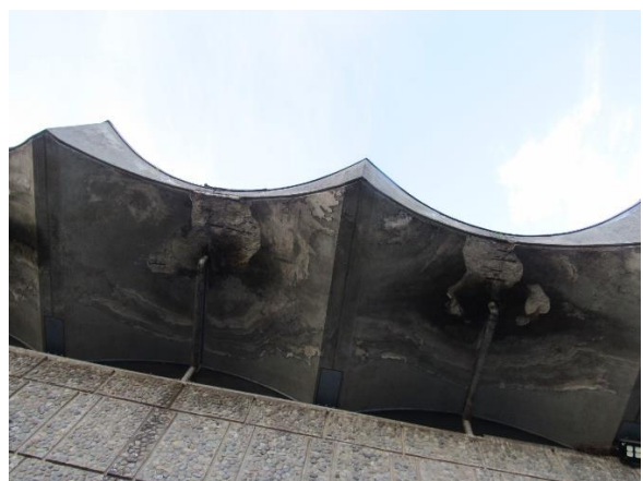
Techumbre: descascaramientos y caída de escombros
